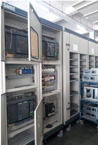
Gambar 5. Letak Pemasangan Differential Relay
