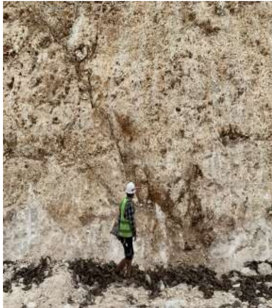
Gambar 2 : Kondisi Kemenerusan Diskontinu Pada Lereng
