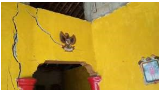
Gambar 6: Rekahan dinding rumah yang sangat intensif akibat tanah bergerak di Desa Tumanggal-Pengadegan.
