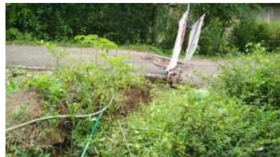
Gambar 4: Longsor yang memotong jalan di Desa Tumenggal.
