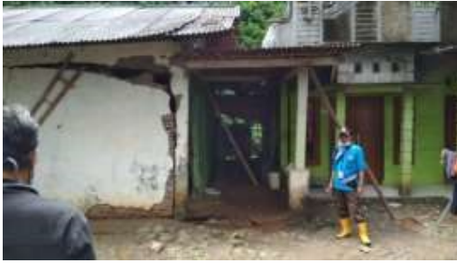
Gambar 5: Pondasi rumah ambles dan dinding retak pada rumah warga di Desa Tumanggal-Pengadegan.
