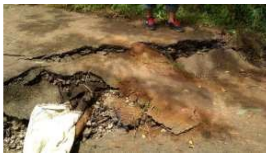
Gambar 8: Amblesan pada jalur jalan akibat longsor di Tumenggal.
