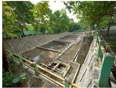
Gambar 6. Instalasi Pengolahan Lindi di TPA Selopuro
